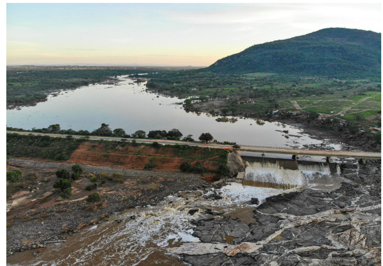
Barragem de Ipanema I em Águas Belas/PE após as chuvas intensas..
