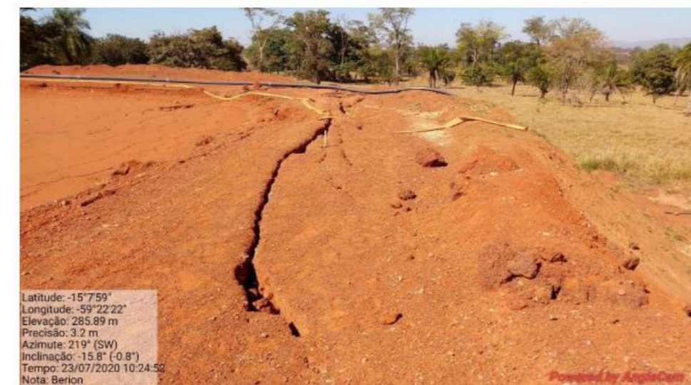
Trincas encontradas na crista da barragem Berion e borda livre insuficiente. Foto: ANM
