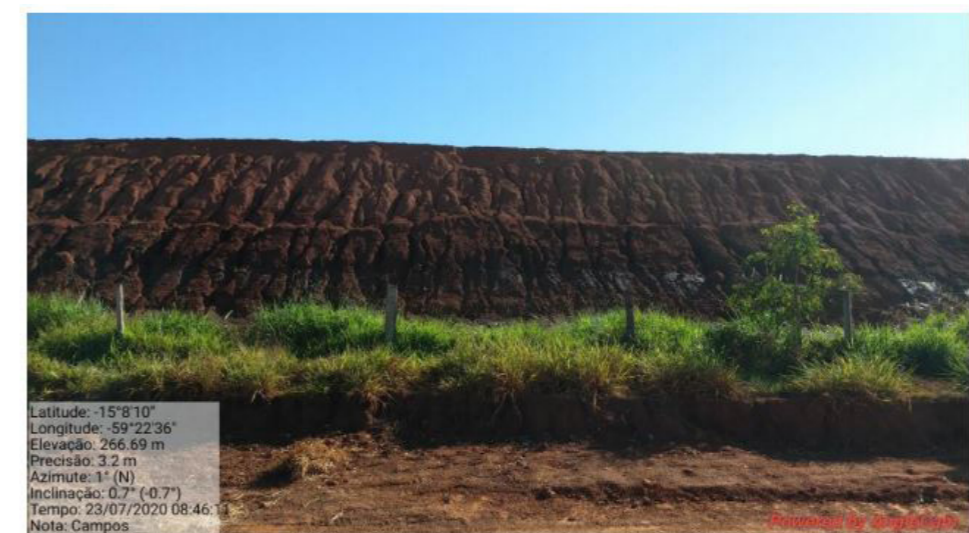
Talude de jusante da barragem Campos com erosões superficiais e destaque para a linha de saturação. / Foto: ANM
