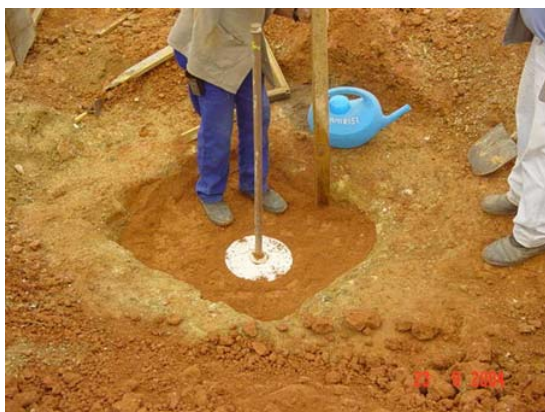
Placa de medidor de recalques (COBA)
