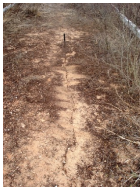
Figura III. 7 – Trinca longitudinal no coroamento
