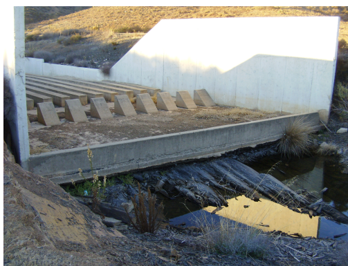
Figura III. 18 – Erosão a jusante da bacia de restituição do vertedouro
