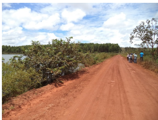
Figura III. 12 – Vegetação de tamanho excessivo no paramento de montante e de jusante
