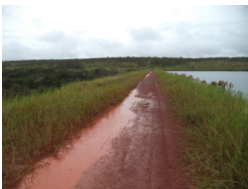
Figura III. 11 – Acumulação da água das chuvas no coroamento
