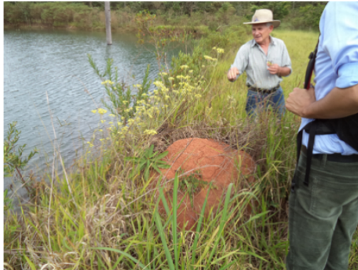
Figura III. 14 – Cupinzeiro no coroamento da barragem
