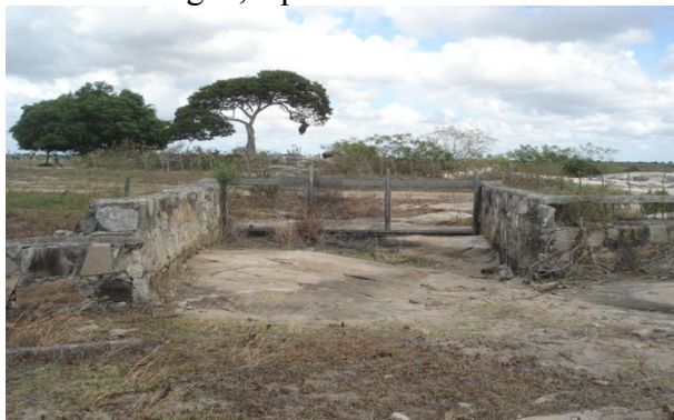
Figura III. 17 – Obstrução da soleira do vertedouro
