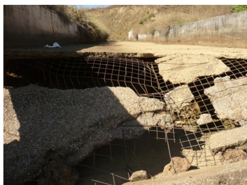
Figura III. 16 – Danos estruturais severos na soleira do vertedouro
