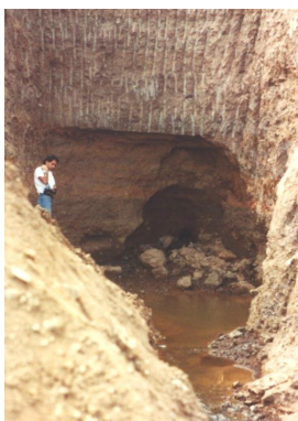
Figura III. 5 – Surgência em torno do conduto da descarga de fundo
