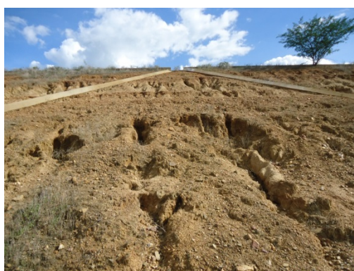
Figura III. 13 – Intenso ravinamento no paramento de jusante
