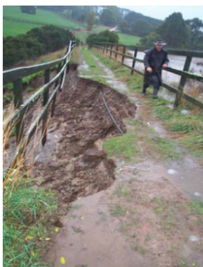
Figura III. 1 – Erosão do maciço de jusante e do coroamento após galgamento da barragem (SMEC, 2005)
