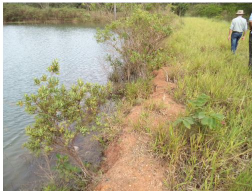
Figura III. 2 – Borda livre insuficiente
