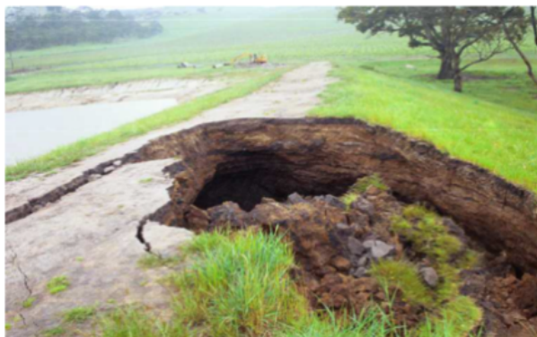
Figura III. 9 – Abatimento no coroamento e no paramento de jusante (SMEC, 2005)
