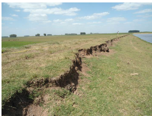
Figura III. 10 – Erosão do paramento montante sob a ação das ondas
