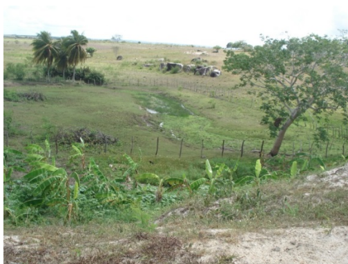
Figura III. 3 – Surgência e zona alagada em zona imediatamente a jusante da barragem
