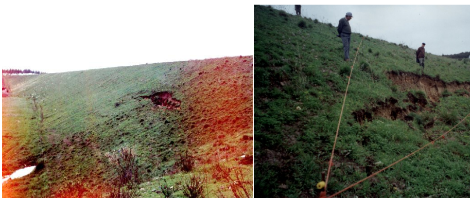
Figura III. 8 – Deslizamento profundo com formação de escarpa
