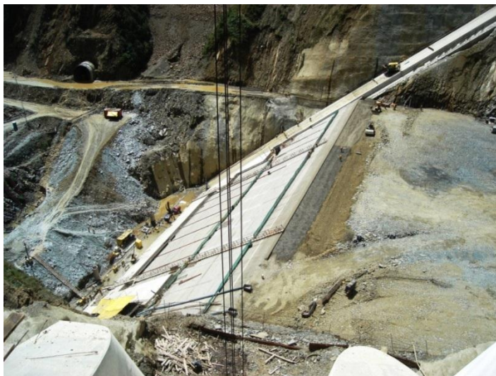
Figura 17. Construção de uma barragem de enrocamento com face em concreto e plinto de fundação. (Fonte: COBA, S.A.)
