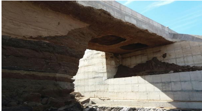
Acidente Barragem de Barreiro/PE
