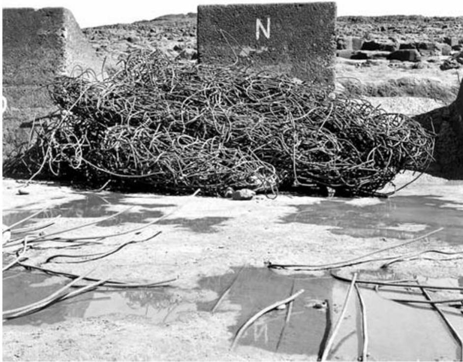
Foto 7 - Detalhe das ferragens arrancadas da bacia de dissipação
